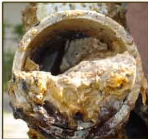
Taponamiento de tubería con grasas y aceites.
