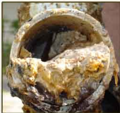
Taponamiento de tubería con grasas y aceites.
